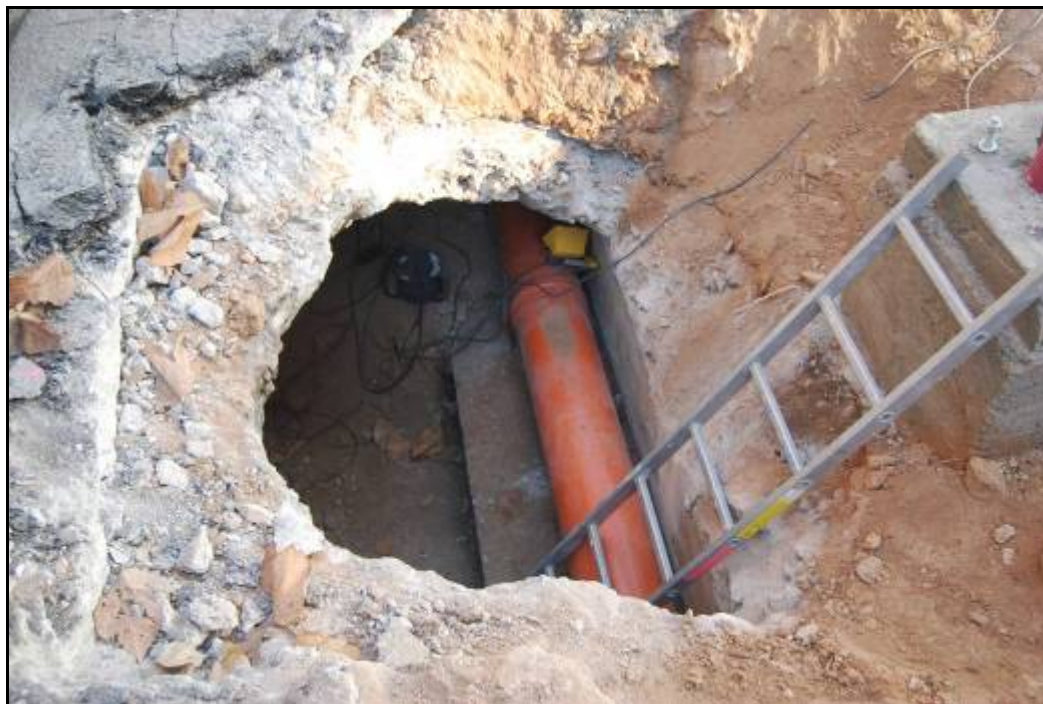
Fotografia núm. 37: connexió dels embornals 1 i 2 mitjançant el col·lector en desús
